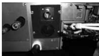
Toma de llenado para tests bomba
