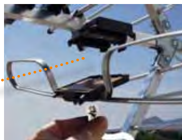
Conexión del cable sin soltar la caja de la antena
